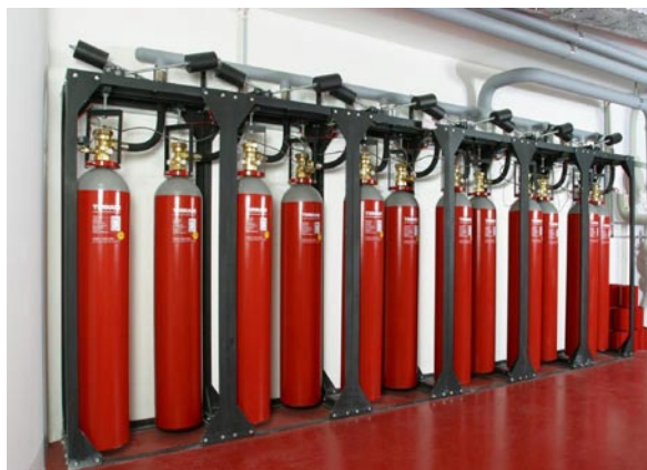
Das Löschgas wird in Druckbehältern vorrätig gehalten. Aufgrund seines hohen Eigendrucks (42 Bar) ermöglicht Trigon 300 Rohrleitungshöhen von über 100 Metern und sehr lange Leitungsnetze.
